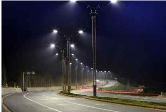
도로/터널 조명 Road and tunnel lighting
